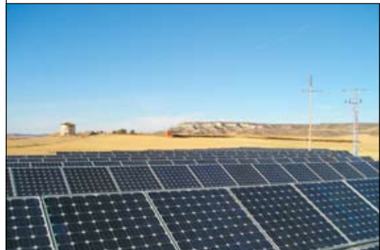
▲ Installation mit Grupo Enepal in Spanien
